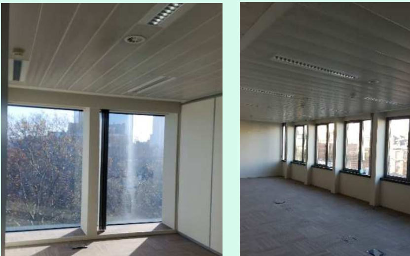
Figuur 10: Bestaand klimaatplafond Regent 47 ©SuReal
