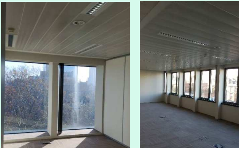
Figuur 10: Bestaand klimaatplafond Regent 47 ©SuReal
